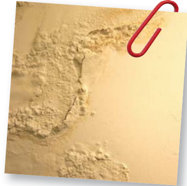
Şekil 2: giderilmeyen rutubetten kaynaklanan hasar
